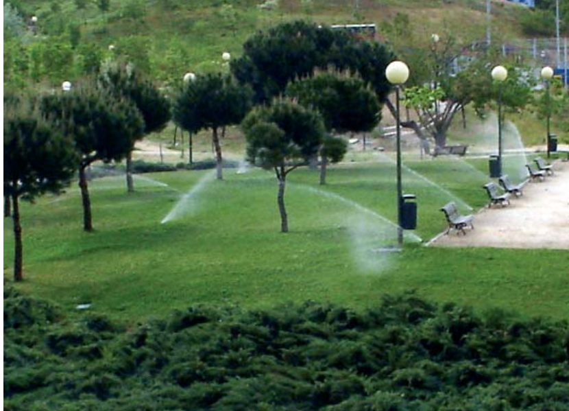
Conservación y mantenimiento de bocas de riego
