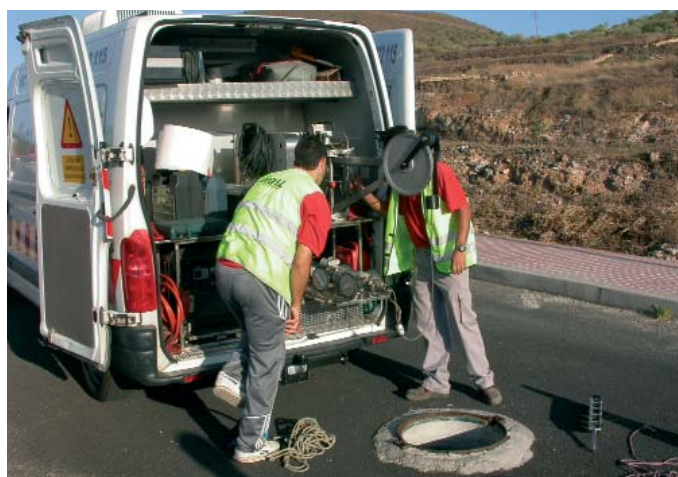
Servicio municipal de aguas en Tenerife. Islas Canarias
