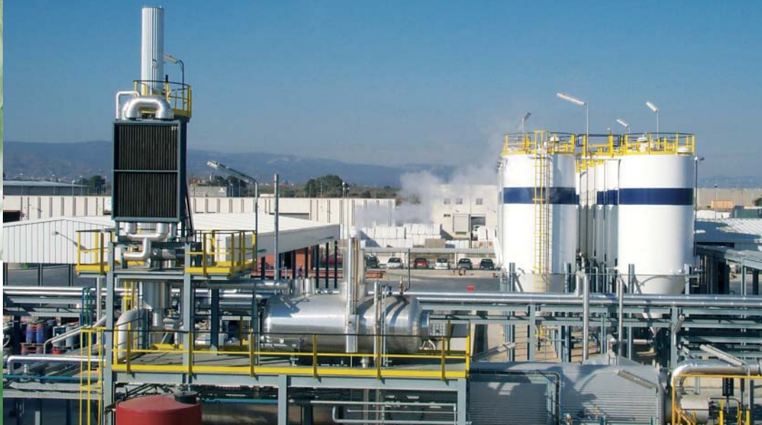
Centro integral de tratamiento de residuos industriales en Constantí. Tarragona
