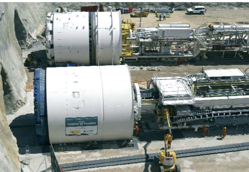
Túnel de Pajares. Pola de Gordón-Folledo en la nueva línea de alta velocidad León-Gijón
