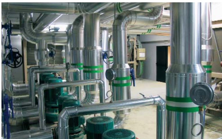
Instalaciones de climatización en el Teatro de El Escorial. Madrid
